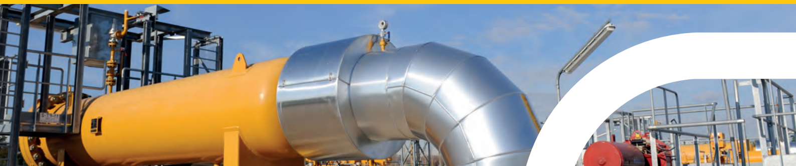
Installation NaTran à Courthézon (84)
